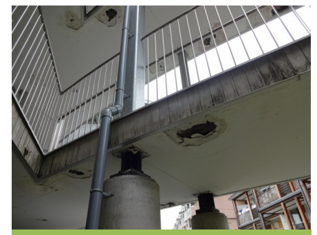
屋外廊下の天井に雨水が入って、天井が落下し、放置されている。
