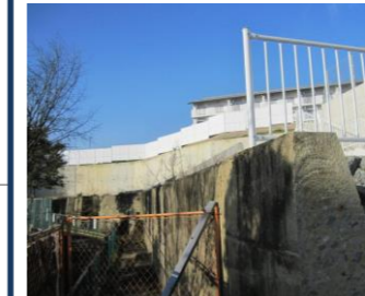
老朽化して傾きかけている擁壁 / 小泉団地
