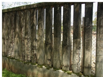
▲老朽化の進む外周柵
