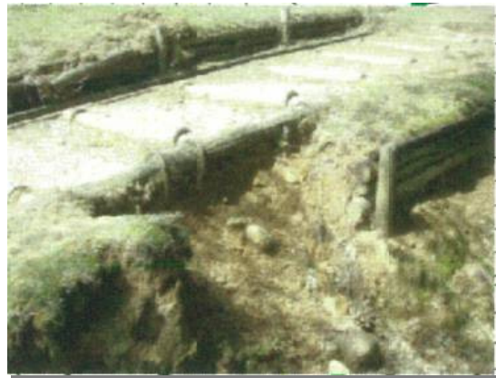
斜面の崩壊、土砂の流出状況(平成22年)
