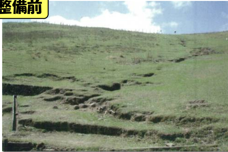
雨水による斜面の浸食状況(平成22年)
