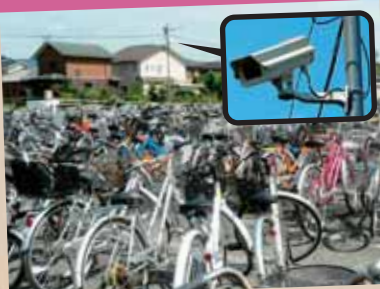
▲駐輪場に防犯カメラを設置しました
