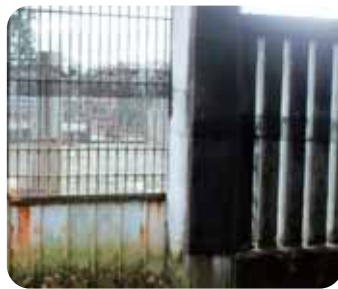
《老朽化した鹿苑の状況》
