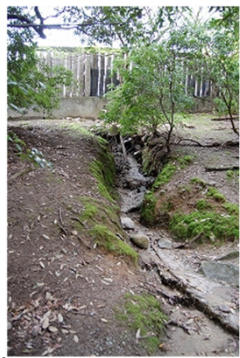
▲施設からの汚水が垂れ流し
