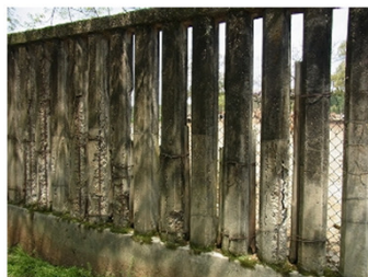
▲老朽化の進む外周柵
