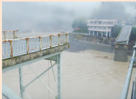
十津川村「折立橋」(被災直後)
