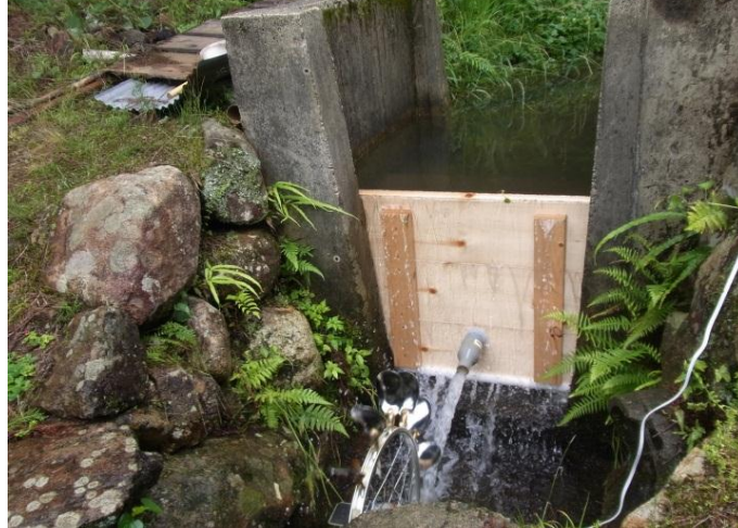
吉野町殿川地区小水力発電施設(健気君1号)
