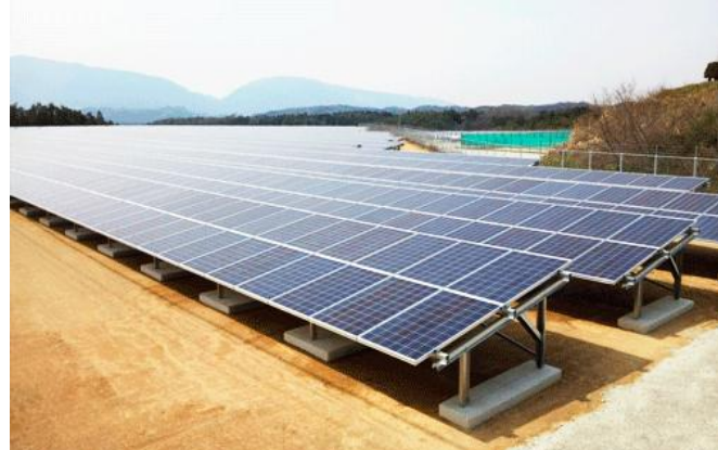
シャープ桧垣本太陽光発電所(大淀町) 平成25年3月商業運転開始 設備容量 2.1MW
