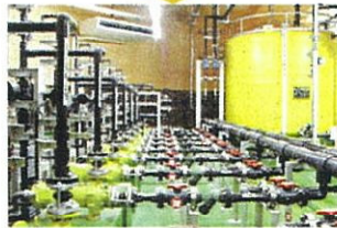
薬品注入設備
