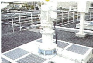
浄水機械設備
