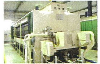
排水処理設備
