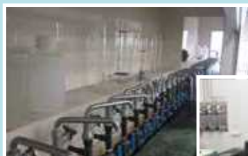
▼浄水処理工程の水質管理
