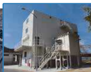
▲活性炭注入施設
