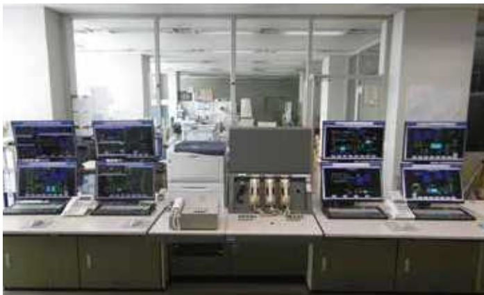
▲ 中央監視・制御システム
