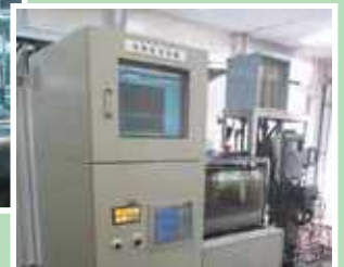
▲魚類水質監視装置(下市取水場) ◆魚を用いて、水の安全性を連続監視
