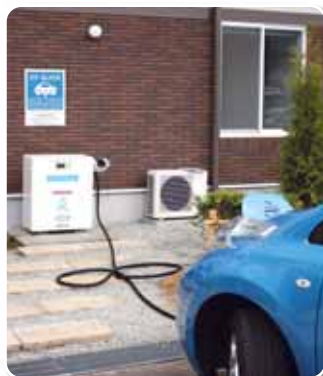
▲電気自動車から電力供給
