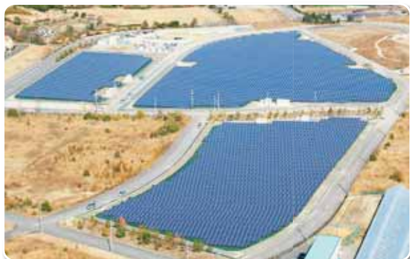
▲約1060世帯分の電力がまかなえる花吉野ソーラー発電所
