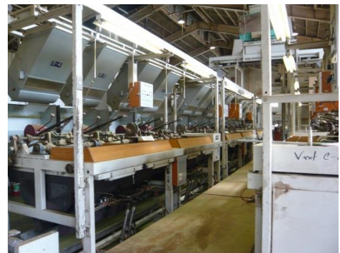
機械化された大型自動製茶工場
