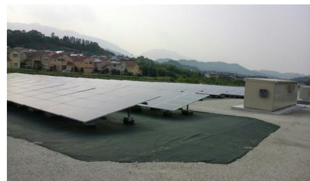
近鉄花吉野太陽光発電所(大淀町) 平成26年3月商業運転開始 設備容量 3.0MW
