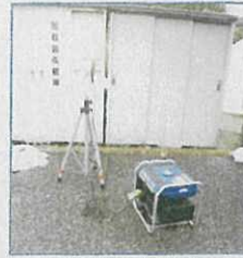
発電機と投光器
