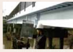
平成25年度に「奈良モデル」のテストケースとして修繕工事が実施された田原本町管理の「中橋」(町道八尾28号線)
