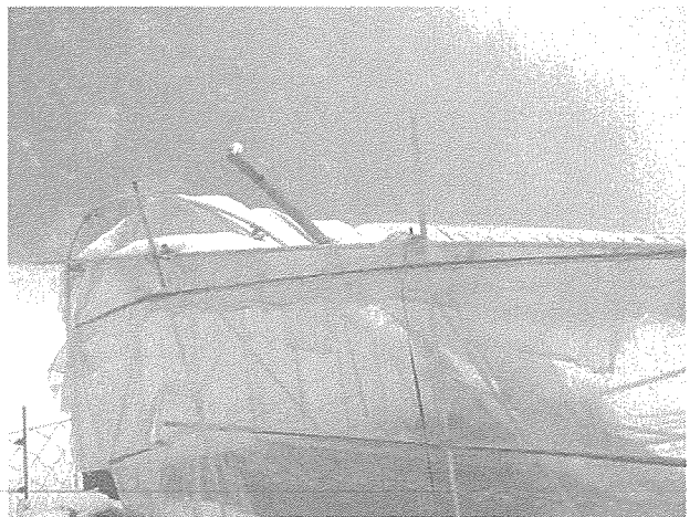
第10図 支柱がずれたことで補強効果がなくなり倒壊したハウス
