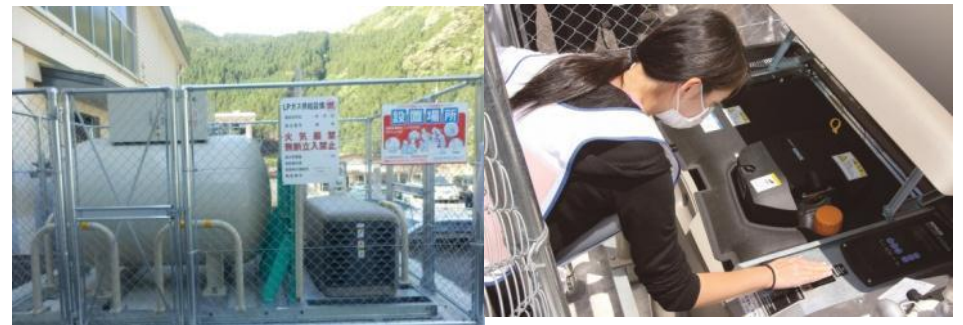
住民参加によるLPガス発電操作訓練
