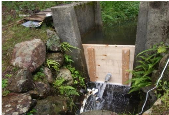
吉野町殿川地区小水力発電施設（健気君1号）
