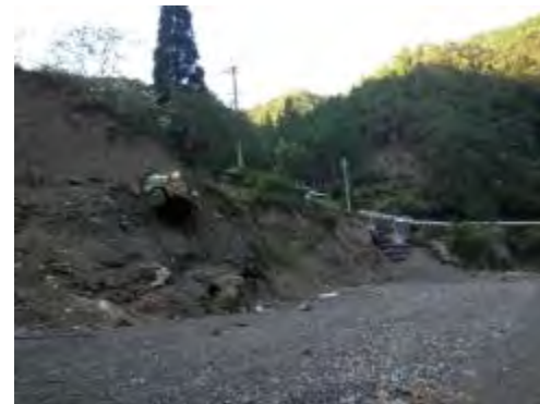
【西川 十津川村西中地区：護岸損傷】
