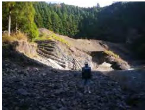
【西川 十津川村小 hands 地区：護岸損傷】
