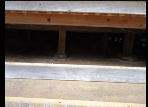
21 床下は、できるだけ高く開放的にして湿気を抜くことが基本だった
