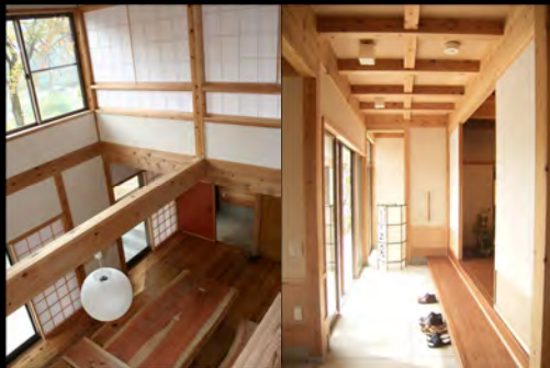
25 内部は真壁により大工の腕が発揮 柱が吸放湿でき、劣化も目視できる
