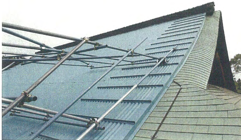
重要文化財 旧一乗院宸殿 屋根応急処置の状況 背面屋根に鉄板を重ねて、 雨漏りを防いでいる。
