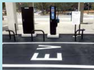
県本庁舎の急速充電器
