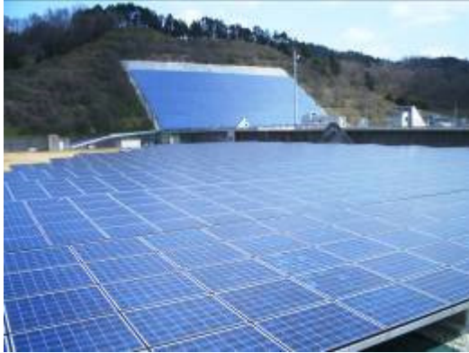
▲太陽光発電システム(御所浄水場)
