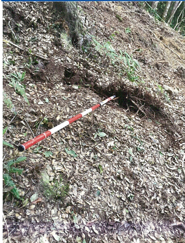
②新たに確認された開口亀裂
