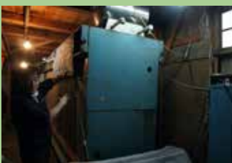
5. Séparation du saké et de la lie (dépôt) dans cette machine
