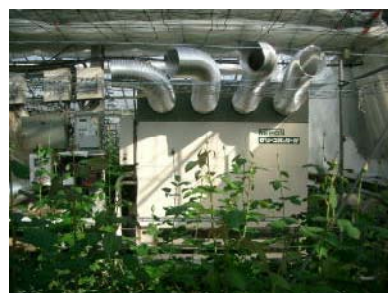
導入されたヒートポンプ
