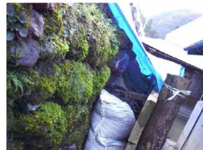
未対策箇所（斜面のはらみ出し）
