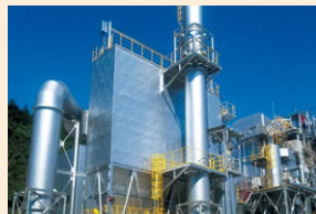
木質バイオマス発電所（大淀町）
