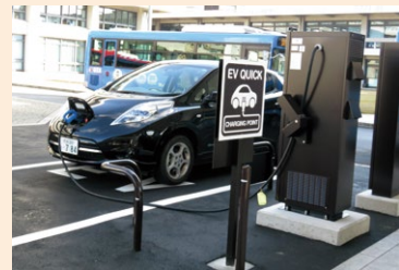
電気自動車急速充電器（県庁正面広場）
