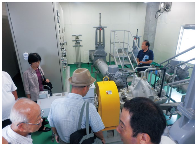
次世代エネルギーパーク見学バスツアー (生駒市山崎浄水場の小水力発電設備)
