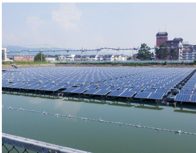
ため池を利用した太陽光発電 (安堵町)
