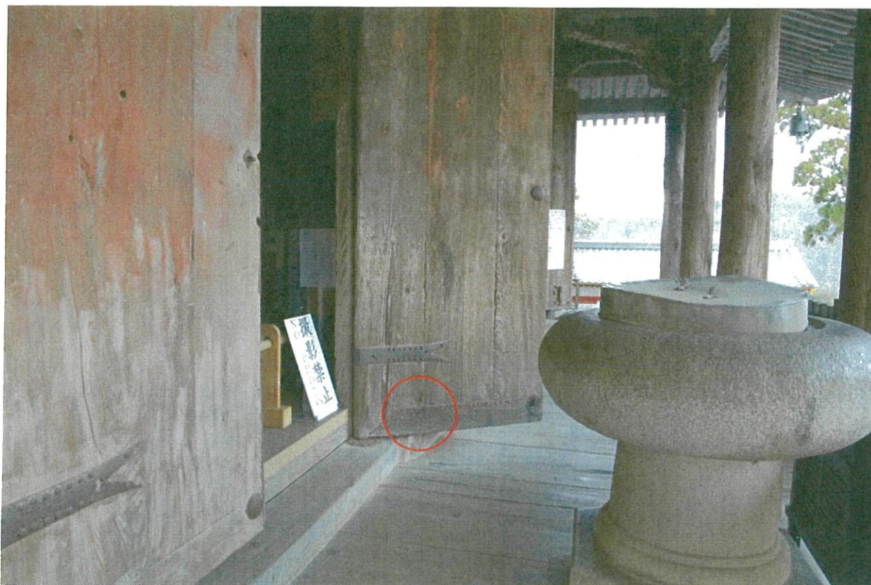
本堂正面、東より4間目の扉板東方、内側下辺あたりに液体痕(赤○印)。
