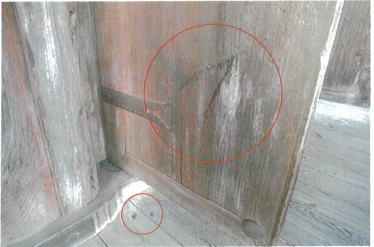
本堂正面、東より6間目の扉板東方、内側下辺あたりに液体痕(赤○印)。
