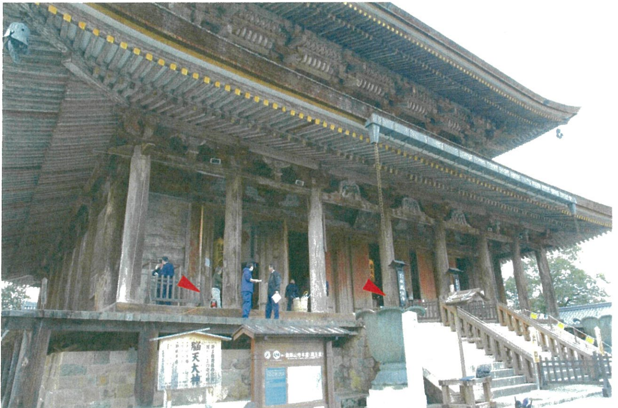
本堂、正面、西南より見る。正面側扉板まわりに液体が残る(赤▲印)。
