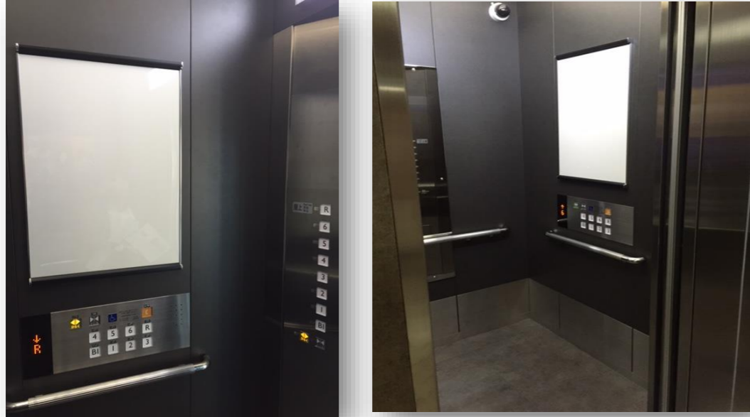
①～④エレベーター
