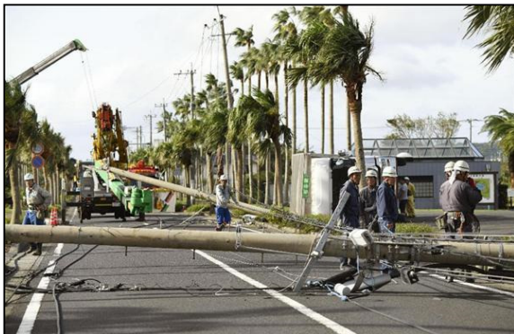
台風16号における電柱倒壊による 車道閉塞の状況(鹿児島県指宿市)
