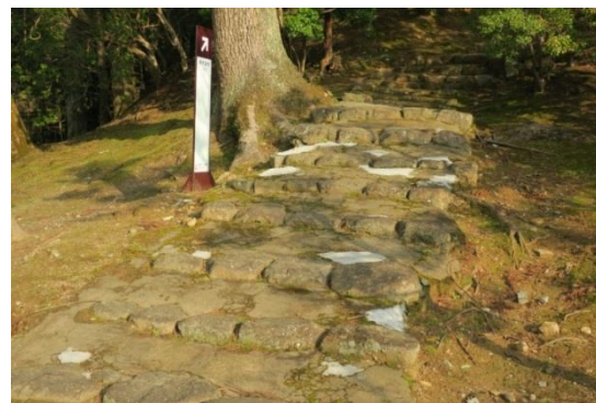
写真: 舗装面が痛んだ階段
