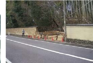
塀の倒壊(平成22年当時)
