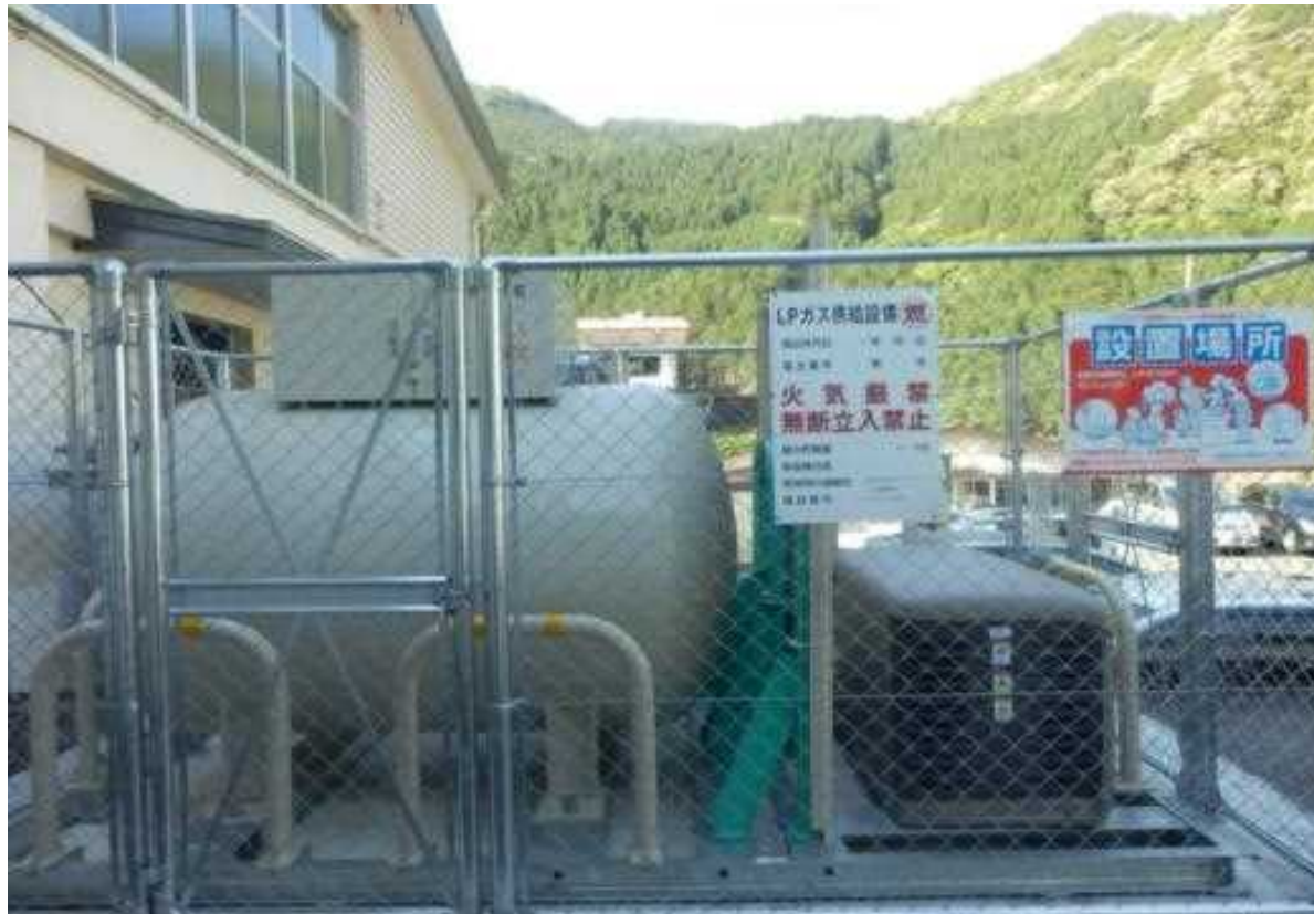
県立十津川高校(十津川村の避難所)のLPガス発電機
