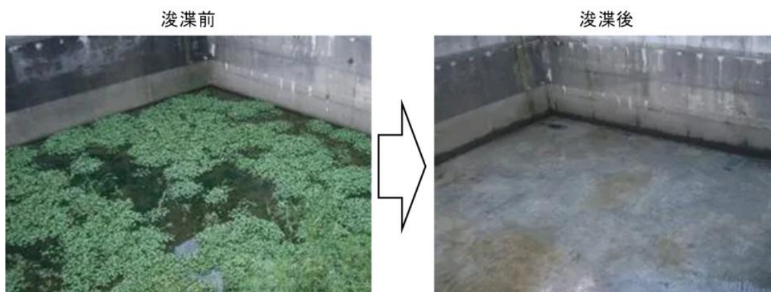
図 6-26 調整池における機能の保全のため定期的な浚渫作業の例（町田市ウェブサイトより）
