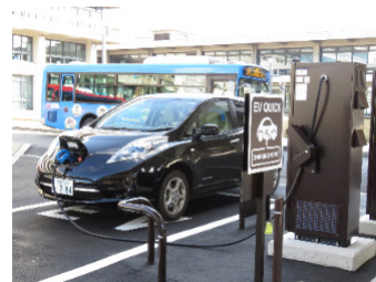
急速充電設備 (県本庁舎)
