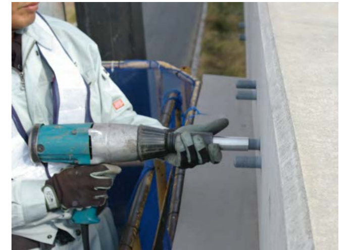
高速道路壁中のボルトナットにジンクハットを取り付けている様子
