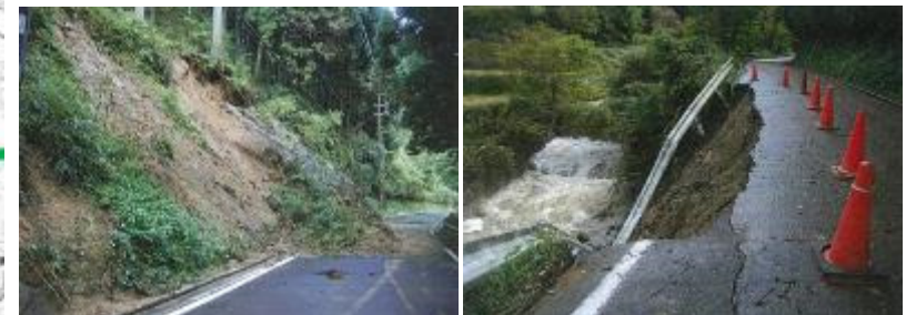
写真1・2 平成29年台風21号による被災状況(崩土・路肩崩壊)
