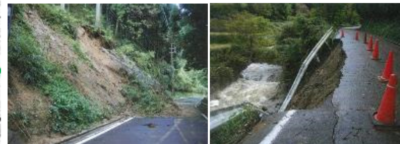
写真1・2 平成29年台風21号による被災状況(崩土・路肩崩壊)
