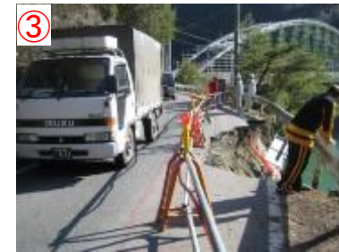
写真3 路肩決壊状況(H18.3.13発生)
