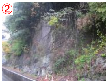
写真2 岩盤崩落の危険性が高い箇所
