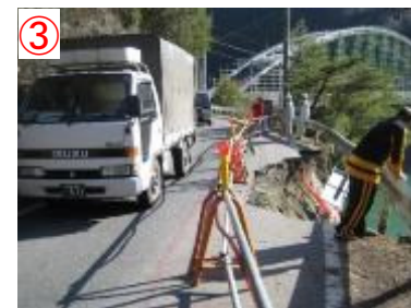
写真3 路肩決壊状況(H18.3.13発生)
