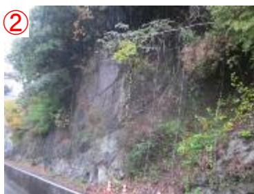
写真2 岩盤崩落の危険性が高い箇所
