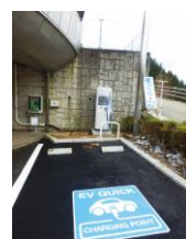
急速充電器の設置(道の駅大塔)
