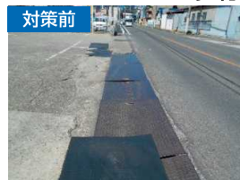
段差があり、高齢者等の通行に支障
