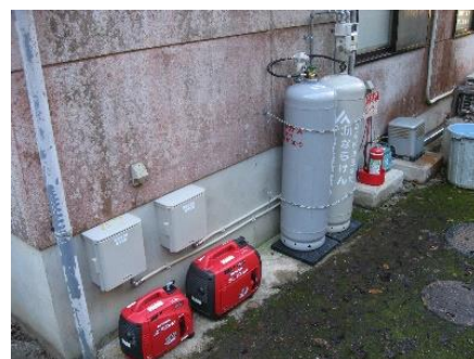
非常用発電機の導入 (桜井市八井内地区)
