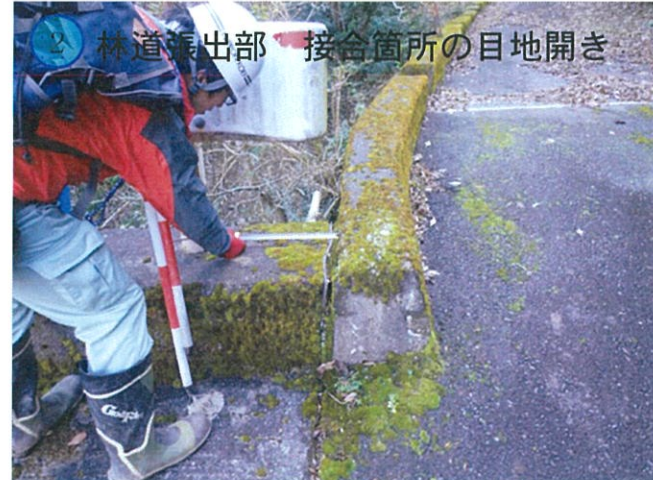
2 林道張出し部 接合箇所の目地開き 林道張出し部接合目地部での開口が確認された。
