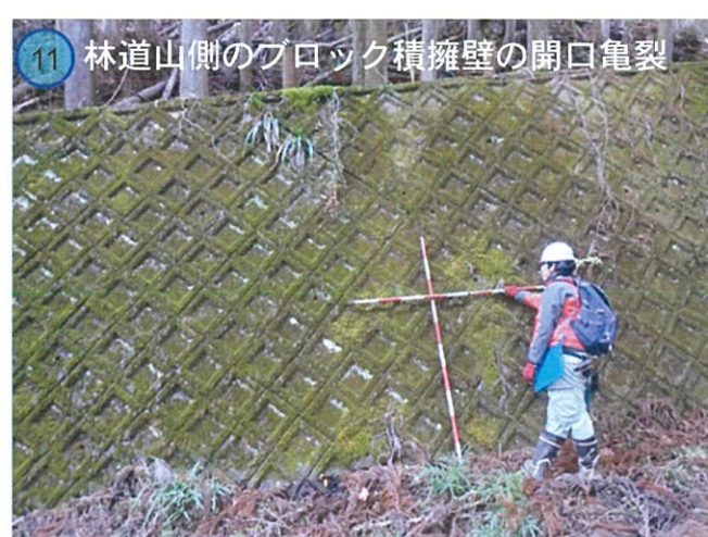
12 林道山側のブロック積み擁壁の開口亀裂 林道山側に設置されたブロック積み擁壁で、ブロックに沿った幅約10mmの開口亀裂が確認された。
