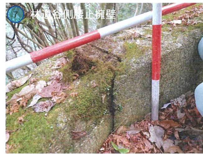
8 林道谷側腰止擁壁 林道の路面亀裂に隣接する谷側の腰止め擁壁目地部が開口している。
