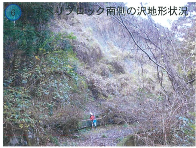
7 地すべりブロック南側の沢地形状況 ポケット式落石防護網が施工済。一部区間では法尻部に土砂が堆積している。
