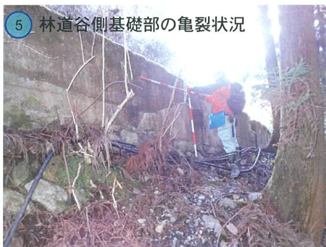
5 林道谷側基礎部の亀裂状況 幅約20mm、段差量約25mmの開口亀裂が確認された。
