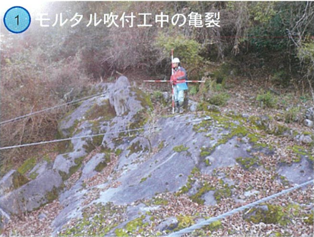
1 モルタル吹付工中の亀裂 モルタル吹付工にて、幅約10mmの開口亀裂が確認された。
