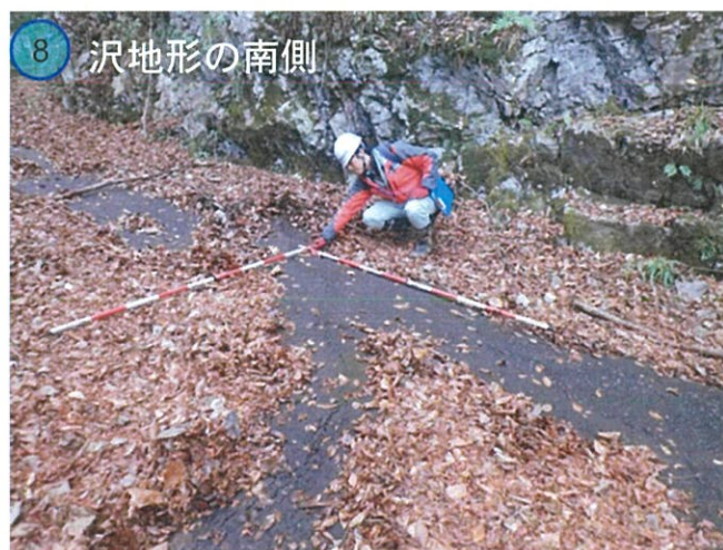
9 沢地形の南側 林道アスファルト路面に若干盛り上がるような圧縮性を示す亀裂が認められる。
