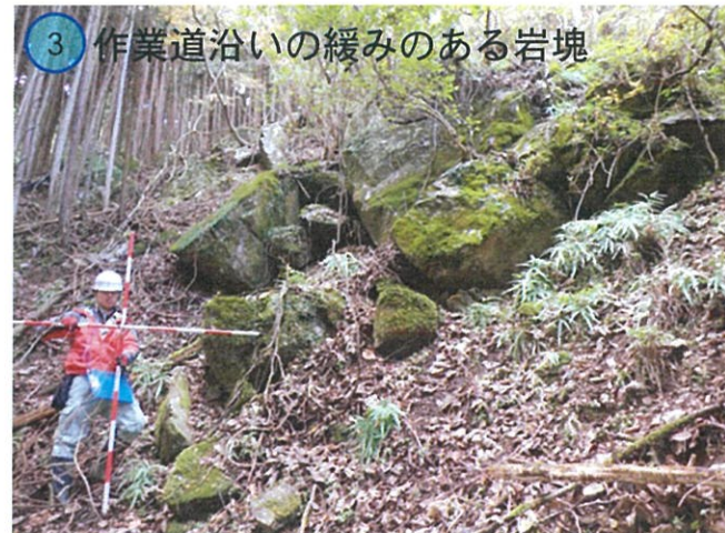
3 作業道沿いの緩みのある岩塊 数十cm~1m以上開口している箇所や、積み石状になっている箇所が認められる。
