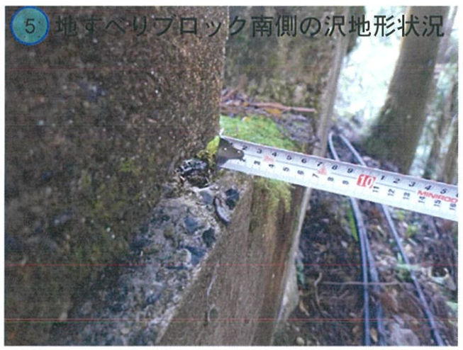
6 地すべりブロック南側の沢地形状況 開口亀裂の拡大写真。
