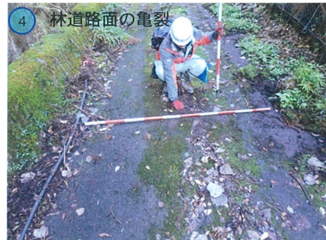
4 林道路面の亀裂 アスファルト路面に若干盛り上がるような圧縮性を示す亀裂が認められた。
