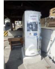
道の駅の急速充電器（十津川村）
