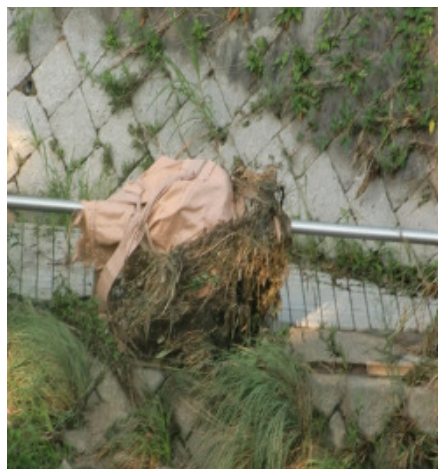
手すりに引っ掛かったごみ
