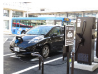
急速充電設備（県本庁舎）
