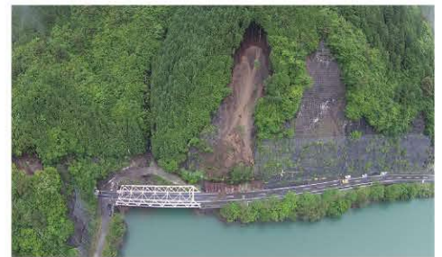
▲国道168号（五條市大塔町小代）被災状況
